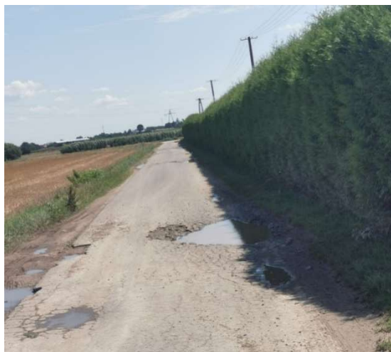
Rys. 44. Droga asfaltowa gminna w obrębie Końskowola wymagająca prac Źródło: Inwentaryzacja terenowa
