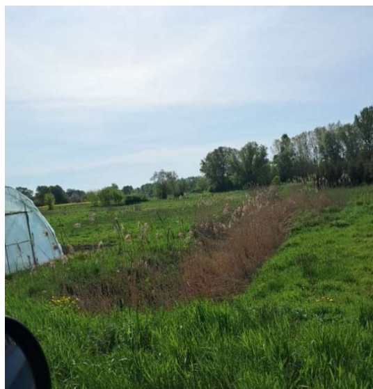
Rys. 27. Rów w Sielcach wymagający konserwacji Źródło: Inwentaryzacja terenowa
