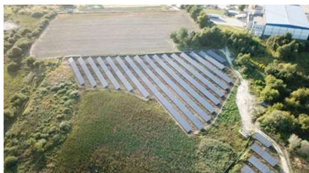
Fot. 32 Farma fotowoltaiczna o mocy 950 kW na terenie gminy Tomaszów Lubelski
